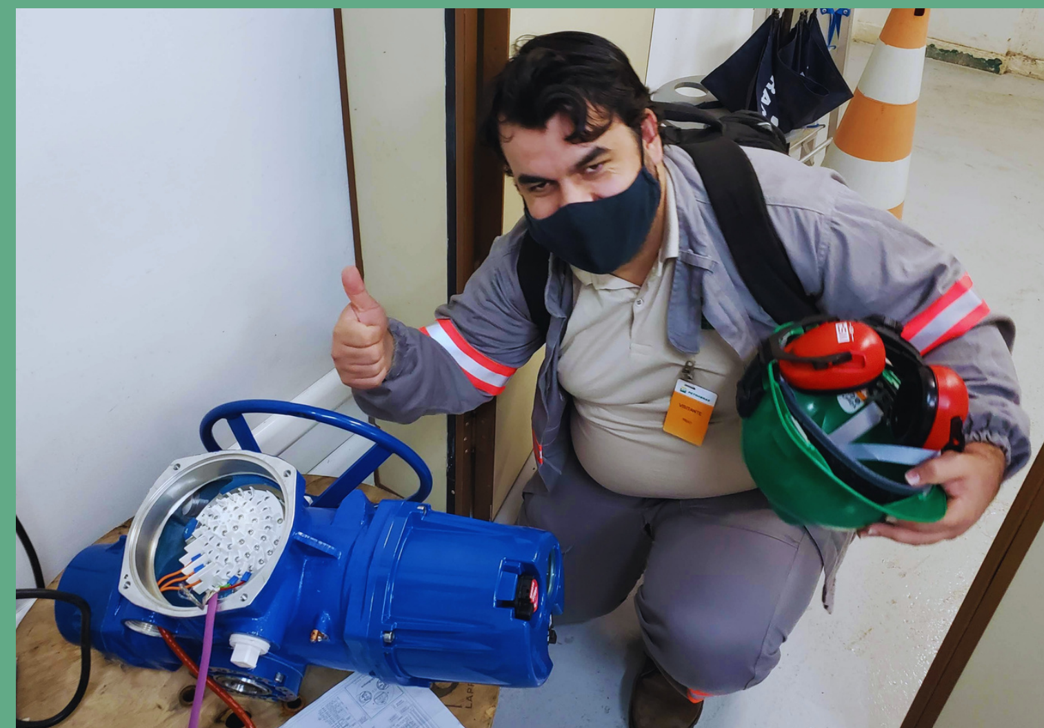
O ATUADOR EM ESCALA (COM O ESPECIALISTA EM AUTOMAÇÃO ILDO AO LADO), PARA SE TER UMA NOÇÃO DO TAMANHO DA MENOR VÁLVULA TROCADA.
