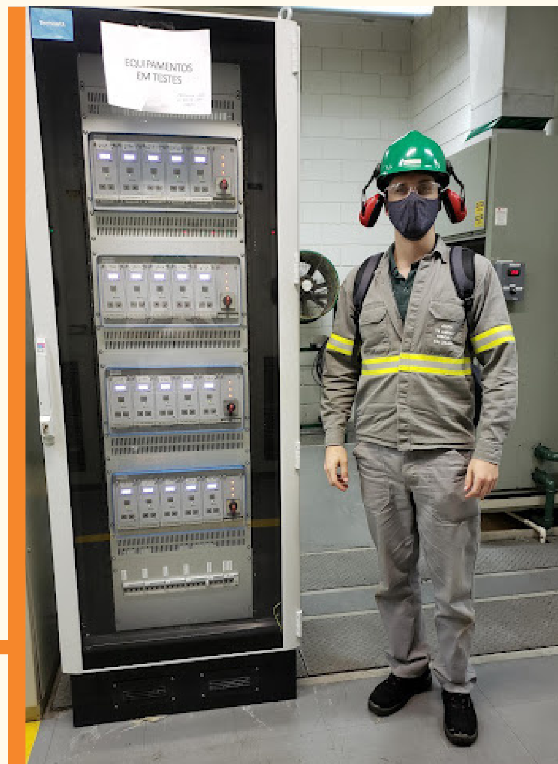
Visão do painel com os 20 geradores de ultrassom.
